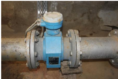
Riebeek Kasteel Reservoirs Inlet (Dia. 150)
