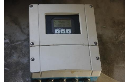
Riebeek Kasteel Reservoirs meter
