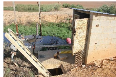
Final effluent PS
