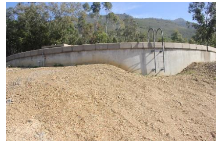
1.200 MI Riebeek Kasteel Reservoir No. 2
